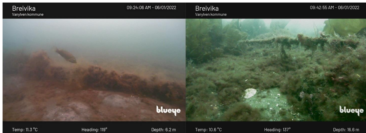
Figur 4: Til venstre: begrodd rør ved B1-1. Til høyre: begrodd kabel (se pil).
